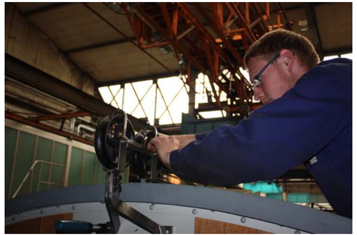
Anbau der Heberleinbremsleinenführung auf dem Führerhausdach.
